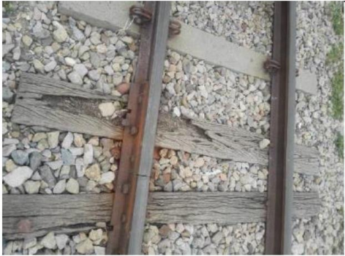
Figura 15 Astilladura e intercalado de durmientes en vía
