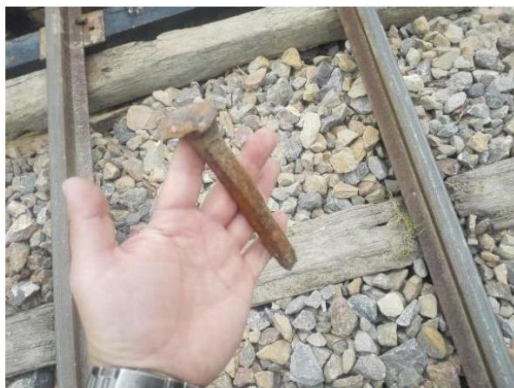
Figura 16 Defecto de no fijación en el durmiente
