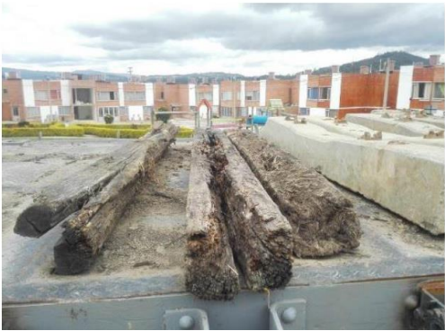
Figura 14 Pudrición del durmiente de madera
